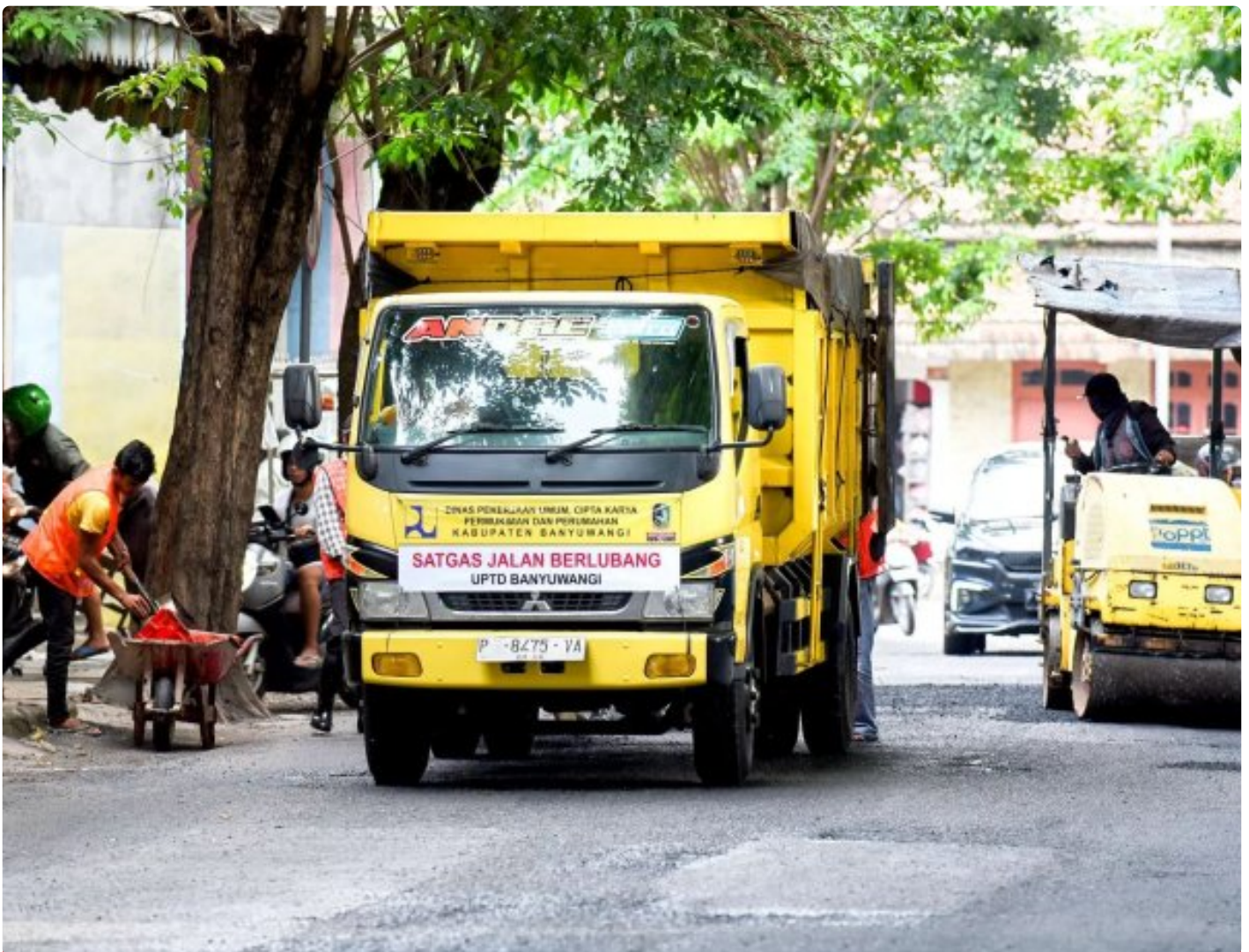
Tim Satgas Jalan Berlubang Dinas PU CKPP sedang menembel jalan berlubang di area jalan sayu wiwit menjelang Hari Raya Idul Fitri 1445 H
